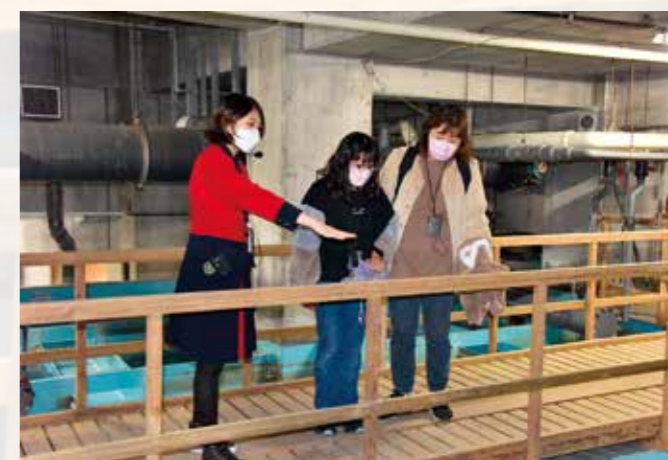
バックヤードツアーで黒潮大水槽のろ過槽をご案内
